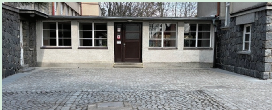
Oprava příchodu ke vchodu do Masarykovy základní školy v Dolní Rovni – výměna poškozeného asfaltového povrchu za původní dlažební kostky.
