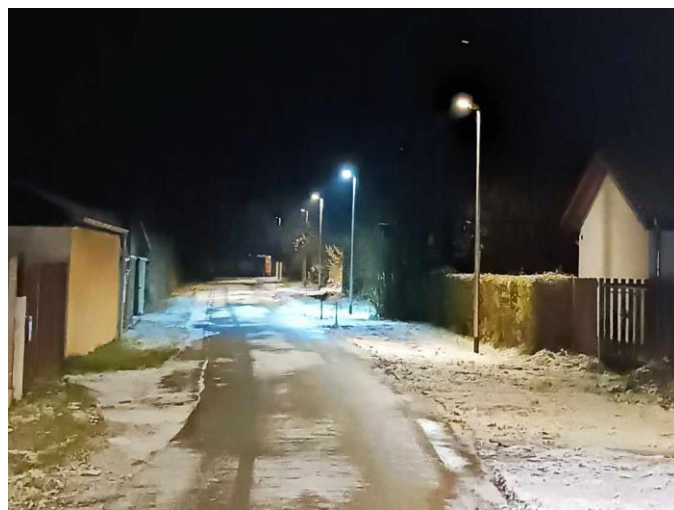
Nové veřejné osvětlení v Litětínách
